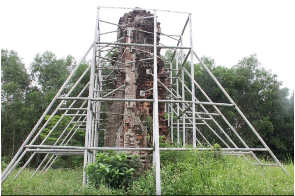
Tháp Sáng hiện cũng đã xuống cấp và đang được chống đỡ. ẢNH: MẠNH CƯỜNG
